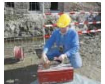
In zahlreichen Kleinsprengungen wurden insgesamt 1.500 Tonnen Fels abgetragen, um Platz für den Neubau zu schaffen. Bilder: Neumayr
